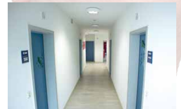
Neue Leuchten über den Zimmertüren zur Signalisierung von Bewohnerrufen.
